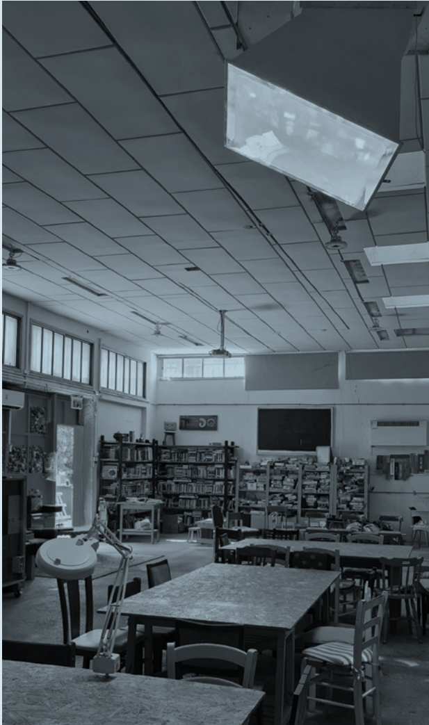
מערכת תאורה טבעית, של חברת סולייט, המותקנת בקיפוד – מרכז הקיימות של עיריית כפר סבא. המערכת מאפשרת הובלת אור שמש בעוצמה של כ־30,000 לומן לתוך המבנה בכל שעות היום, וכן מערכת שליטה המבטיחה שמערכת התאורה הטבעית תמיד תהיה מקור האור העיקרי במבנה, וכך מאפשרת התייעלות מרבית בצריכת אנרגיה | צילום: שלומית קיטרו
