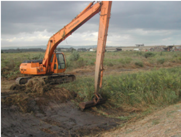
מְחַפֵּר (באגרו) מפנה סחף קרקע וצמחייה מתעלה המתנקזת לנחל נעמן. הפינוי (כמו גם כיסוח הצמחייה) הוא פרקטיקת תחזוקה נפוצה, המבוצעת תדיר לפני החורף כדי לייעל את זרימת המים. הפינוי אומנם משפר את הניקוז בטווח הקצר, אולם פוגע בתפקוד האקולוגי | צילום: אמיר פרלברג
