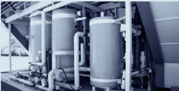
אנרגיית השמש שמייצר הבניין נאצרת במכלי מים חמים. קירור המים באמצעות צינת הלילה מאפשר את קירור המבנה ביום | צילום באדיבות סולאר דקטולון ישראל
