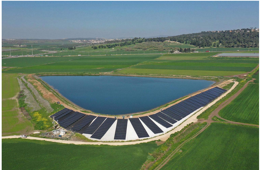
מערכת פוטו-וולטאית על דופן מאגר ליד נהלל, בעלת הספק מותקן של 900 קילוואט | באדיבות תשרי אנרגיה בע"מ
