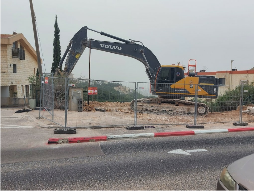
דחפור מכין את השטח לפרויקט חדש של תמ"א 38, במקרה הזה פניו הבניין הישן לטובת בניית בניין חדש. שכונת כרמליה, חיפה | צילום: דניאל אורנשטיין
