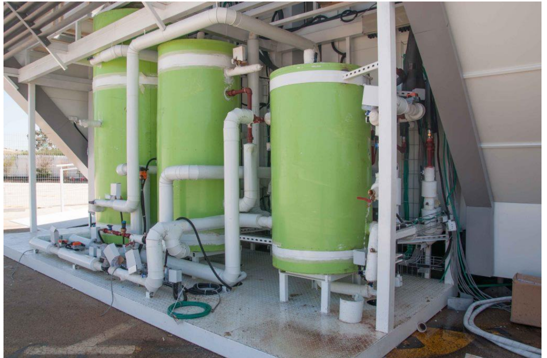
אנרגיית השמש שמייצר הבניין נאצרת במכלי מים חמים. קירור המים באמצעות צינת הלילה מאפשר את קירור המבנה ביום | צילום באדיבות סולאר דקמלון ישראל
