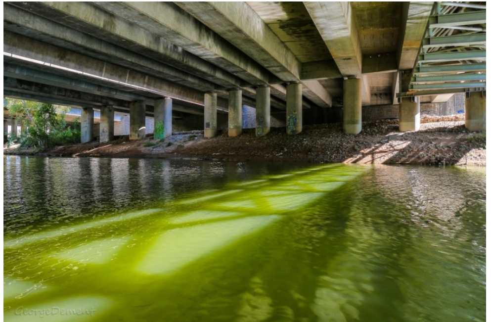
תעלת נחל איילון. הקמת מסילת רכבת רביעית בתוואי התעלה מחייבת מציאת פתרון לזרימה בנחל – במעלה האגן או באמצעות מנהרה שתטיט את הזרימה למוצא בחופי יפו | צילום: GeorgeDement, Flickr, CC BY-SA 2.0
